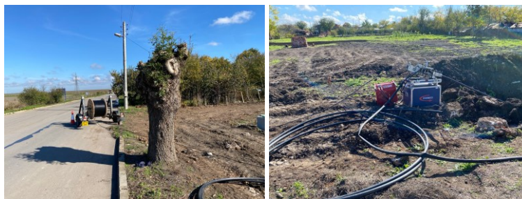
Фиг. 1.7. Полагане на HDPE тръба и оптичен сноп по магистрално трасе Варна – Балчик – ГКПП Дуранкулак, с. Хаджи Димитър, община Каварна, ноември 2025 г.
